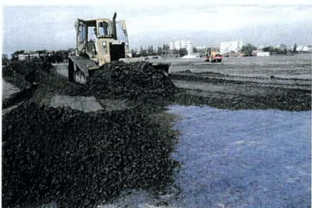
Barena del Passo a Campalto. Copertura dell'area con geocomposto bentonitico sopra il quale vengono stesi materiali diversi (sedimenti di dragaggio, sabbia e terreno vegetale)
