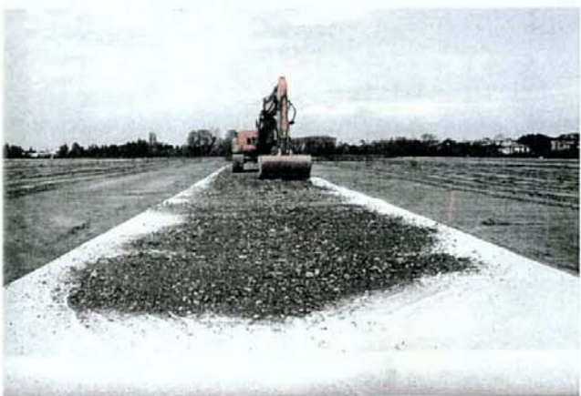
Barena del Passo a Campalto. Preparazione di piste per la movimentazione dei mezzi di cantiere
