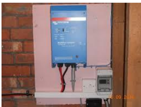
Sistema di accumulo elettrico
