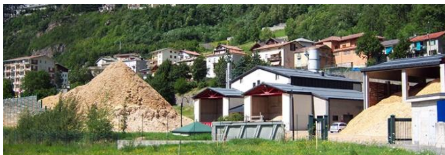
Impianto di produzione di energia a cippato di legno
