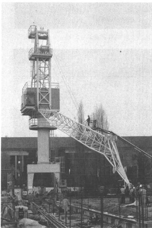
In queste foto: sopra vista del bacino durante i lavori di restauro del paramento murario con la nuova gru a servizio della sponda destra; a lato, installazione della nuova gru sempre della sponda destra del bacino medio
