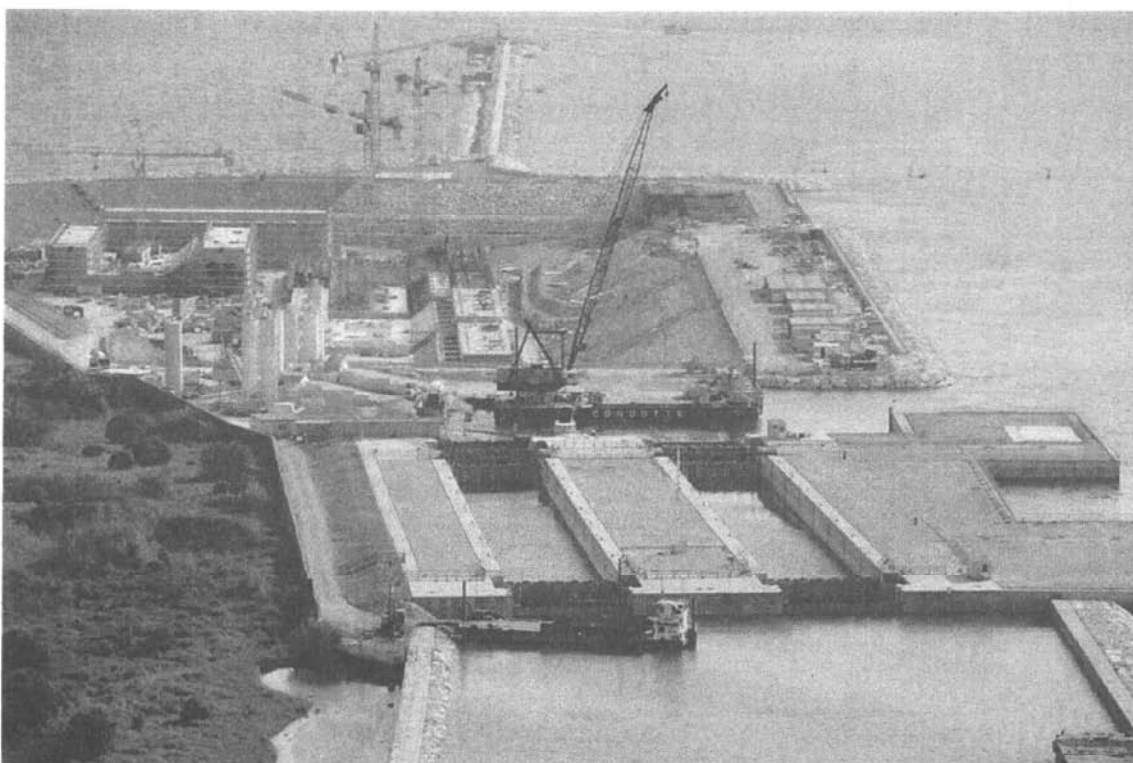
Bocca di Chioggia : in primo piano le conche di navigazione per pescherecci. In alto il bacino lato mare messo all'asciutto e utilizzato come tura per la costruzione dei cassoni di soglia e di spalla
