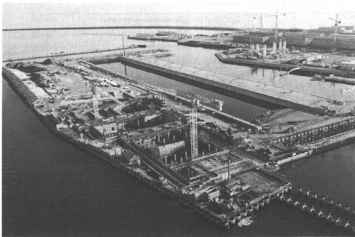
Bocca di Malamocco: particolare della vasca ove verranno ubicati gli impianti e gli edifici tecnologici
