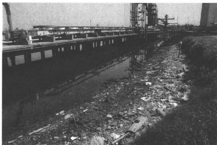
Canale Industriale Sud sponda Syndial Polimeri Europa: stato di fatto di un tratto di marginamento
