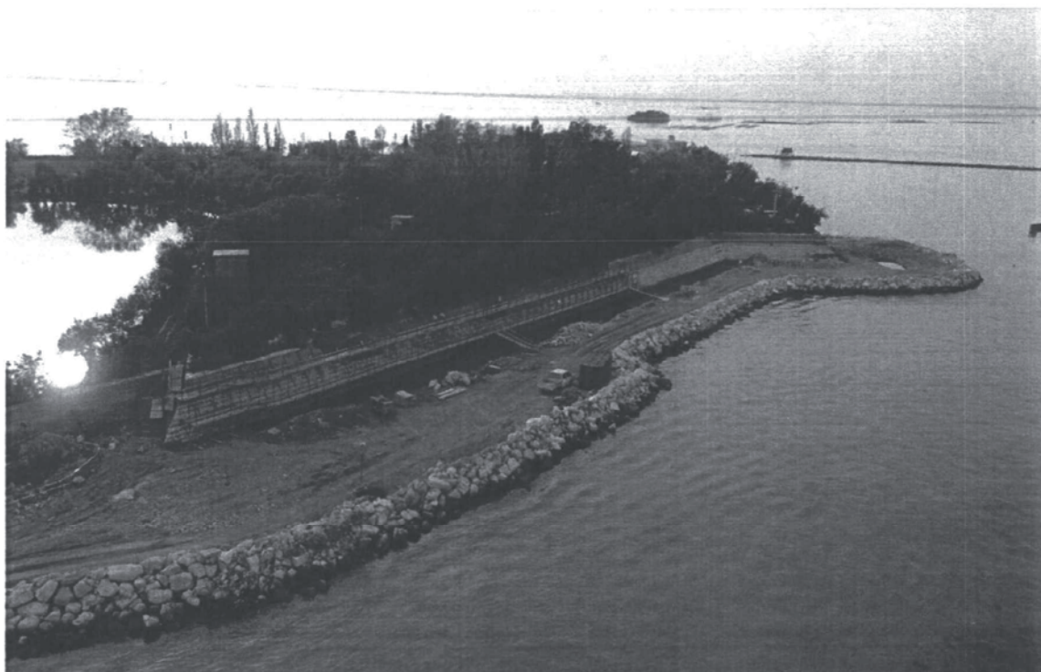
Bocca di Malamocco : vista generale dell'area delle attività per la protezione della sponda del Forte S. Pietro. Si notano in particolare le impalcature per il restauro delle vecchie murature del forte
