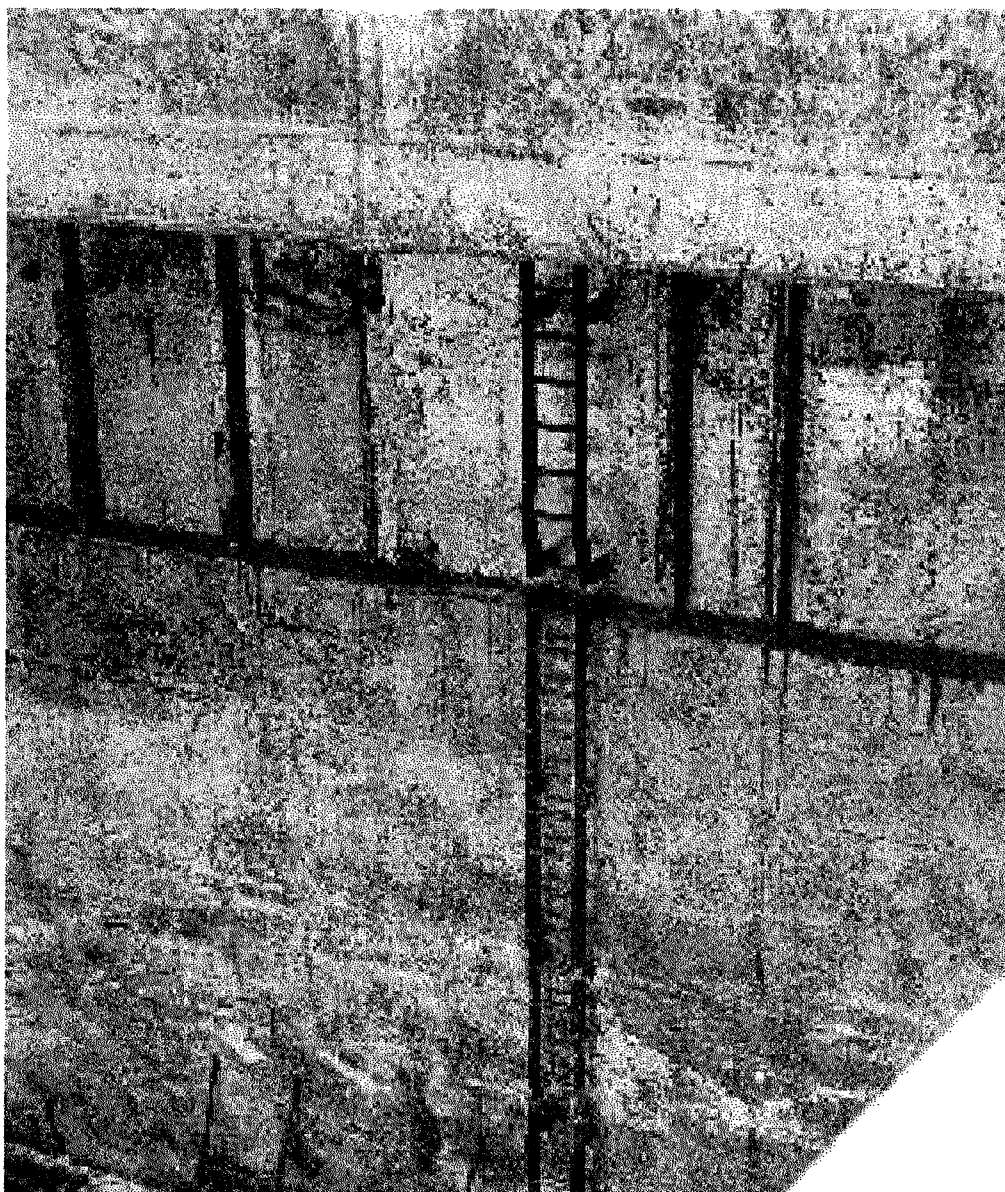
Foto 1 - Problema: lunghe scale verticali di accesso alle stive
