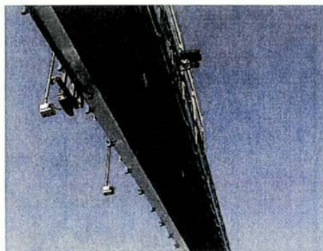
Fig. 2 - Vista dei dispositivi installati sul sovrappasso pedonale nel sito sperimentale
