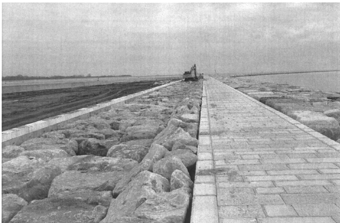
Bocca di Lido - S. Nicolò : particolare della pavimentazione e della scogliera realizzata nell'ambito del rinforzo della radice del molo sud.
