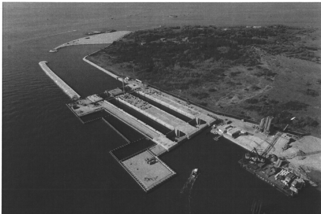
Bocca di Chioggia : le due conche di navigazione per pescherecci, con le opere civili delle camere e degli alloggiamenti delle porte già completate. In primo piano, la parete combinata che delimita le strutture della spalla nord.
