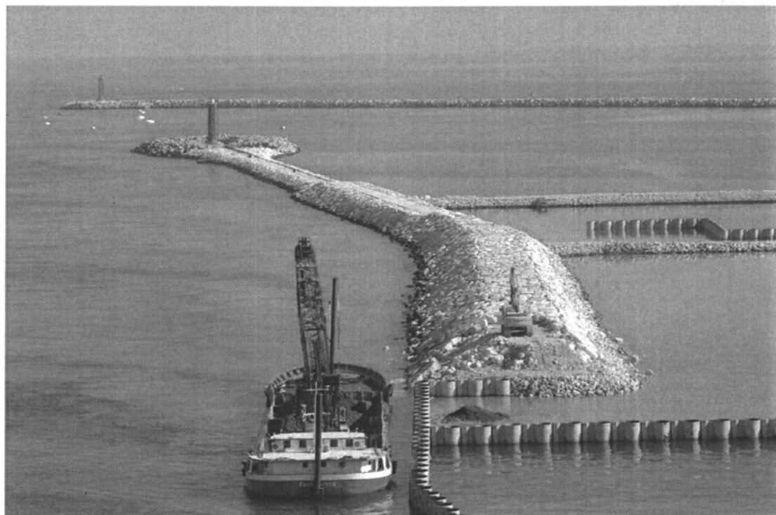
Bocca di Malamocco : particolare del molo sud rinforzato e della parete combinata che costituisce la spalla sud della barriera. Sullo sfondo la diga foranea già completata.
