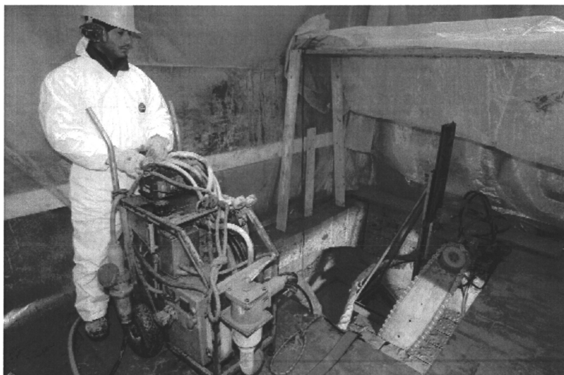
Indagini strutturali e statiche all'interno della loggetta. Nell'ambito di queste attività è stato possibile realizzare anche alcune lavorazioni preliminari all'avvio degli interventi.
