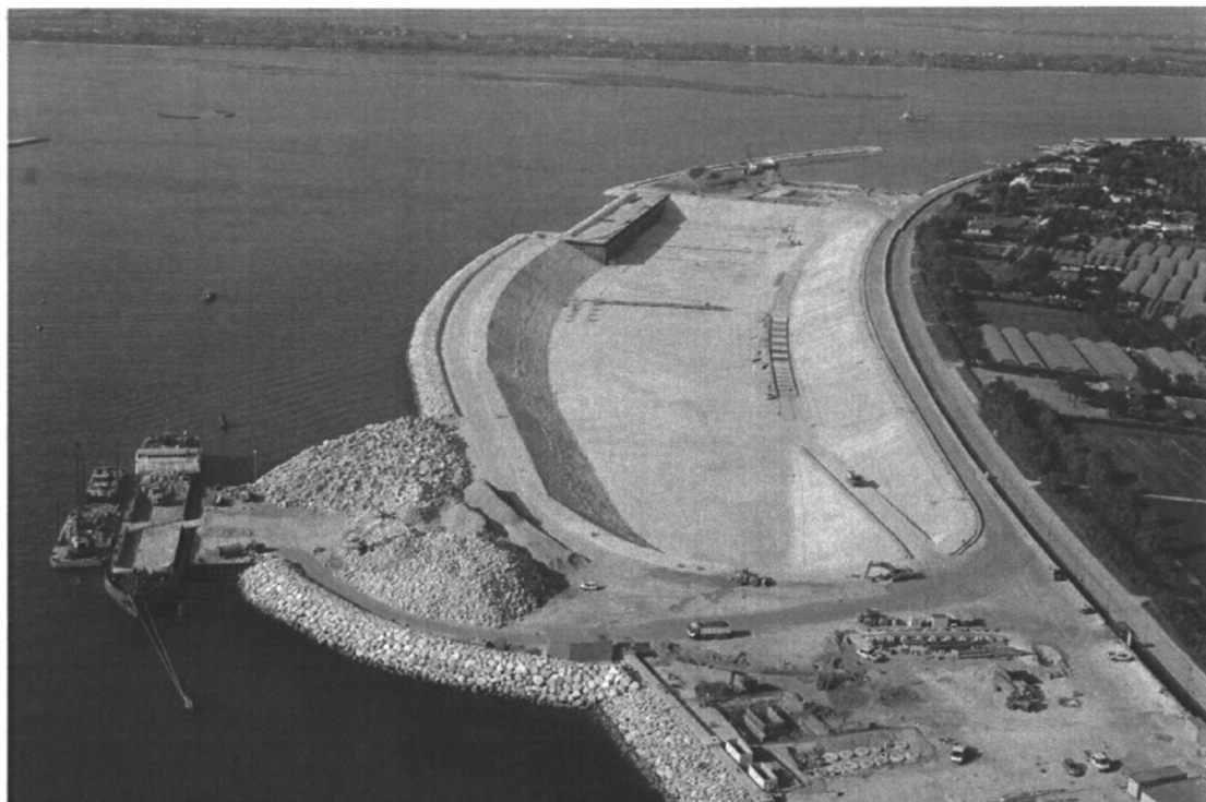
Bocca di Lido - Treporti : particolare del bacino del porto rifugio lato mare messo all'asciutto. Sono in costruzione le strutture delle piastre per la prefabbricazione dei cassoni. Nella parte alta della foto, il "cofferdam" che verrà demolito per far uscire i cassoni in galleggiamento una volta realizzati.
