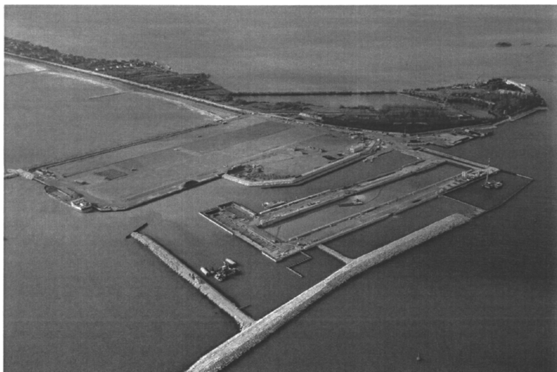
Bocca di Malamocco : da destra verso sinistra: la parete combinata collegata al molo sud che costituisce la spalla sud della barriera; la conca di navigazione per grandi navi; il cantiere provvisorio su rilevato per la prefabbricazione dei cassoni di alloggiamento delle paratoie della barriera di Malamocco; sullo sfondo il litorale di Pellestrina.
