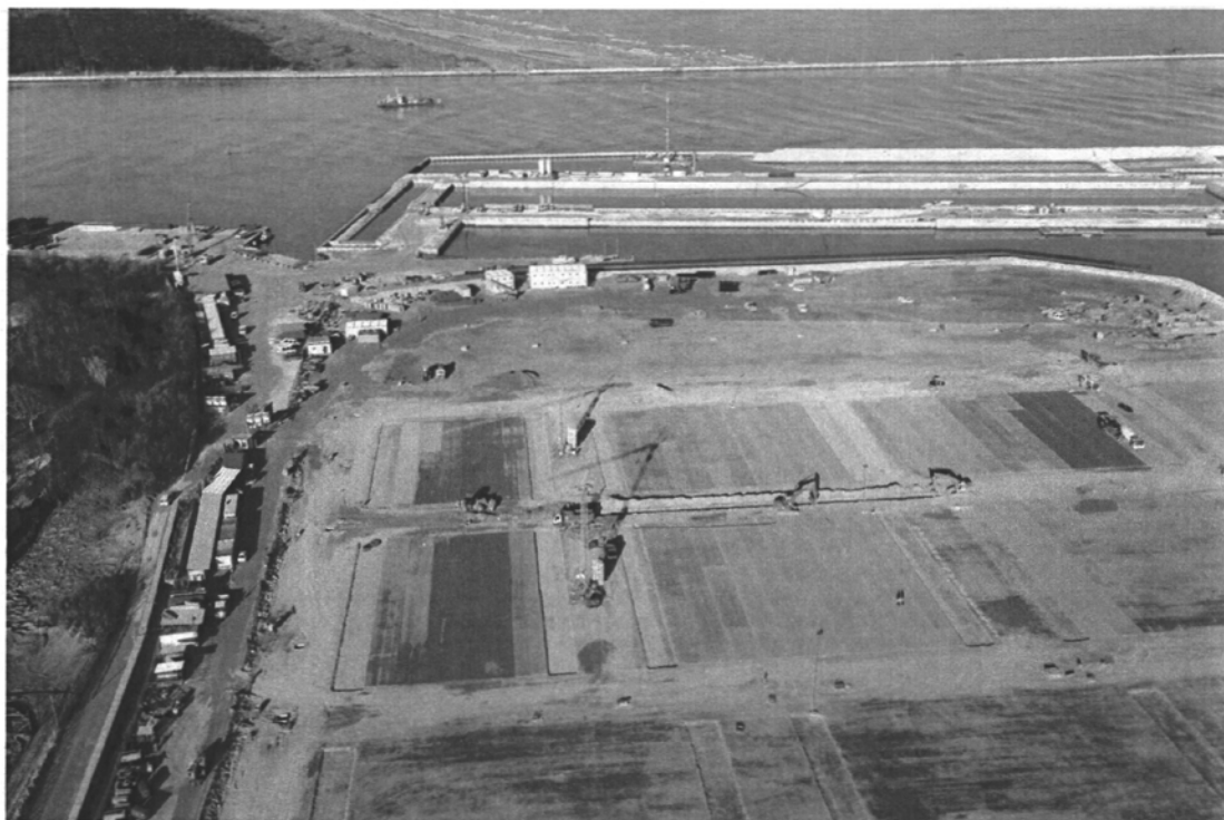
Bocca di Malamocco : Infrastrutture per la prefabbricazione dei cassoni, realizzazione delle piastre sul rilevato.
