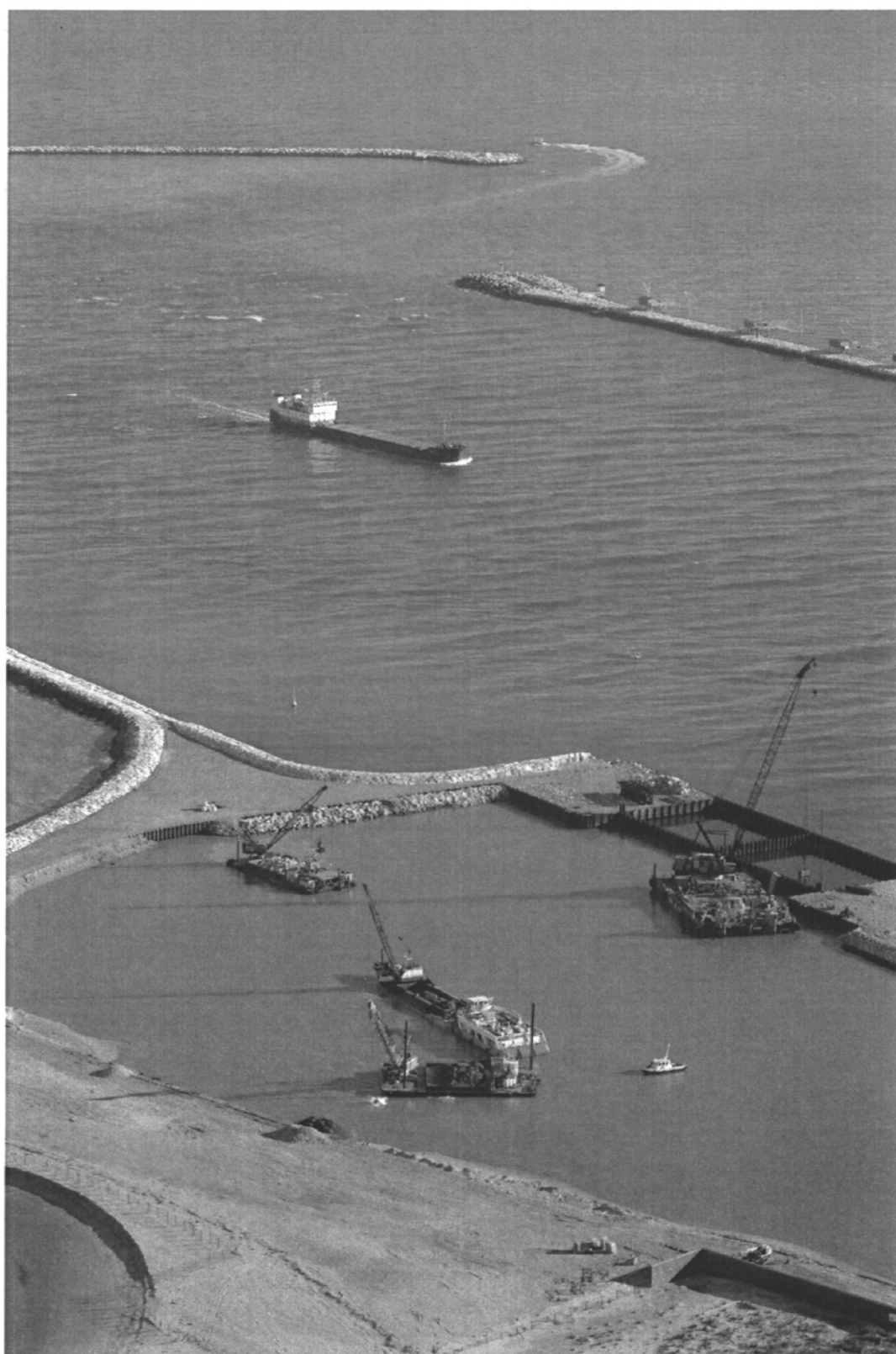
Bocca di Chioggia : porto rifugio lato mare, mezzi al lavoro per il dragaggio del bacino e l'infissione delle palancole per la realizzazione del bacino in vista della sua messa all'asciutto.
