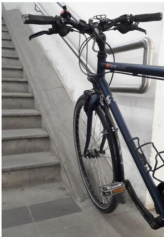
Scala con canalina, stazione RFI di Torino Lingotto
