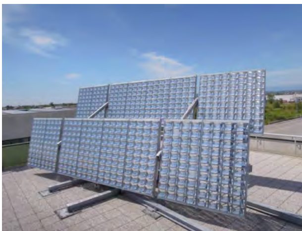
Prototipo di sistema fotovoltaico a concentrazione. Sono stati installati in tutto quattro di questi prototipi, per una potenza totale di circa 18 kWp.
